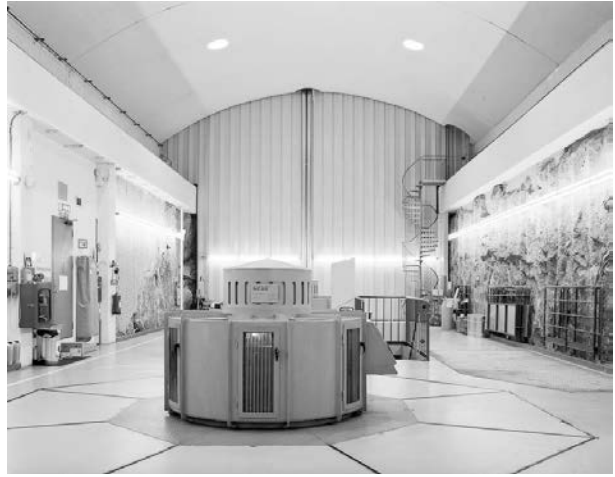
Generator, Bjelland kraftverk 2007 Fotograf: Per Berntsen
