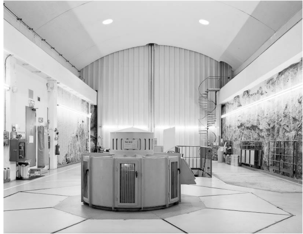
Generator, Bjelland kraftverk 2007 Fotograf: Per Berntsen
